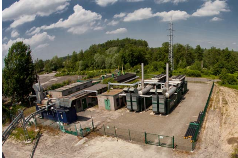
Obr. 3 Těžební středisko František s kogeneračními jednotkami.
